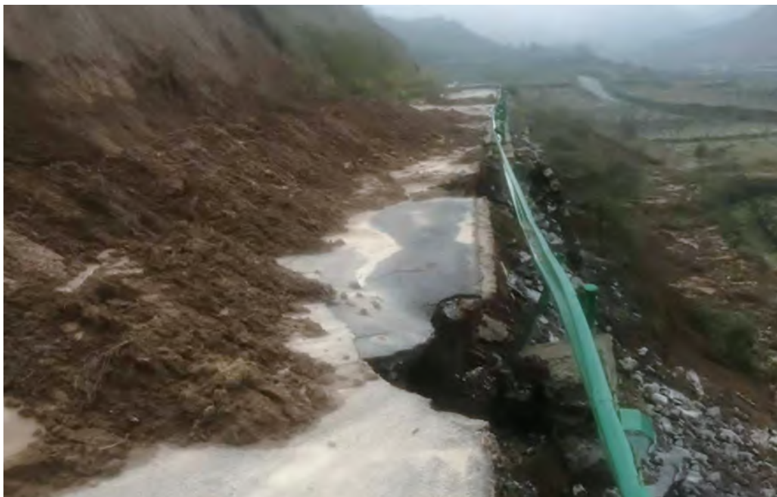
© 2021年9月18日，合阳出现暴雨。图为暴雨后的百良镇陌东至榆林沿黄路坡道滑坡场景
